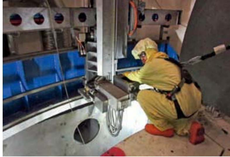
Check des Brennschneidmastes
